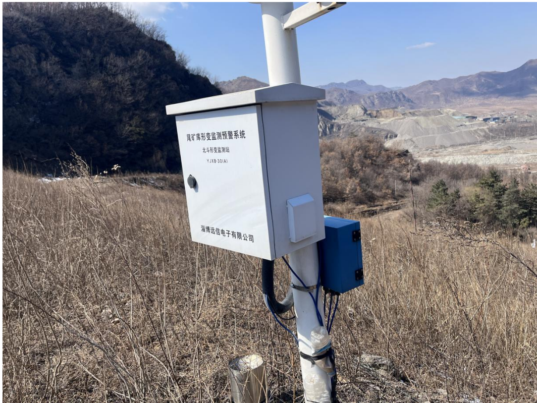
图 2.7-3 位移监测系统
