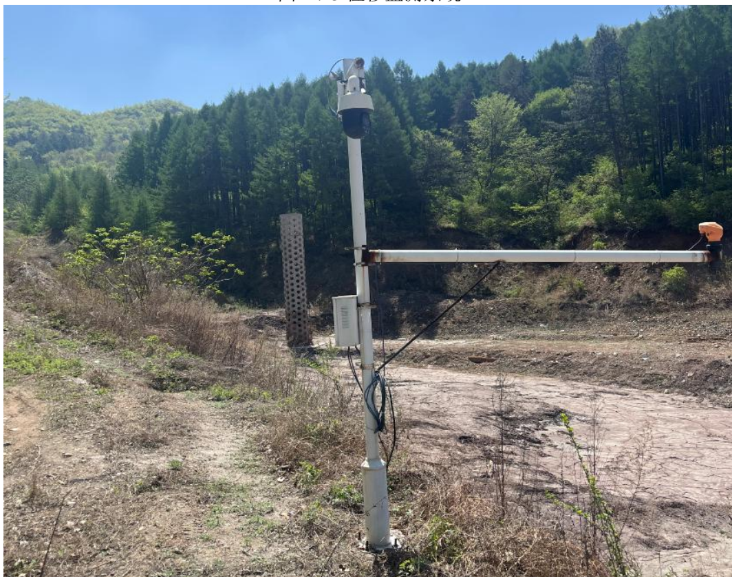
图 2.7-4 视频监控和库水位监控系统
